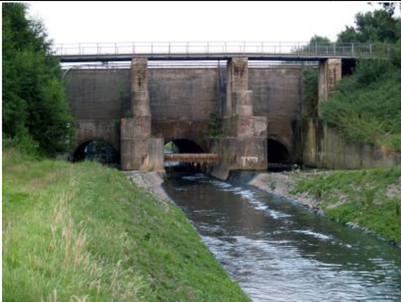
Emscher-Düker bei Castrop-Rauxel 2 Le siphon près de Castrop-Rauxel
